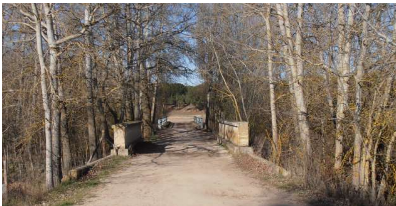
Fig. 11. Pretil de piedra y de hierro en los puentes del molino de Carracuéllar
